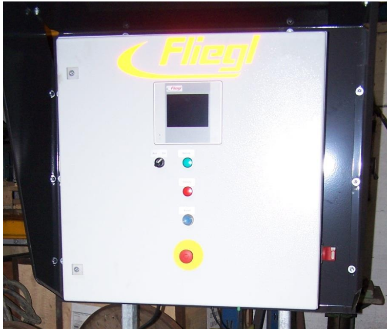
Fig. 1 Armadio elettrico Controllo "DigiTouch Bio" come controllo
